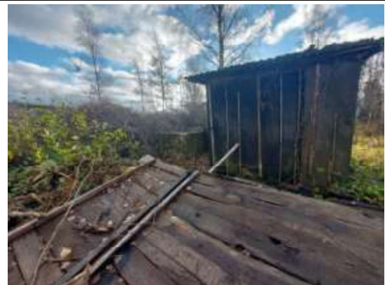
Nereģistrētās būves grausts un pamati
